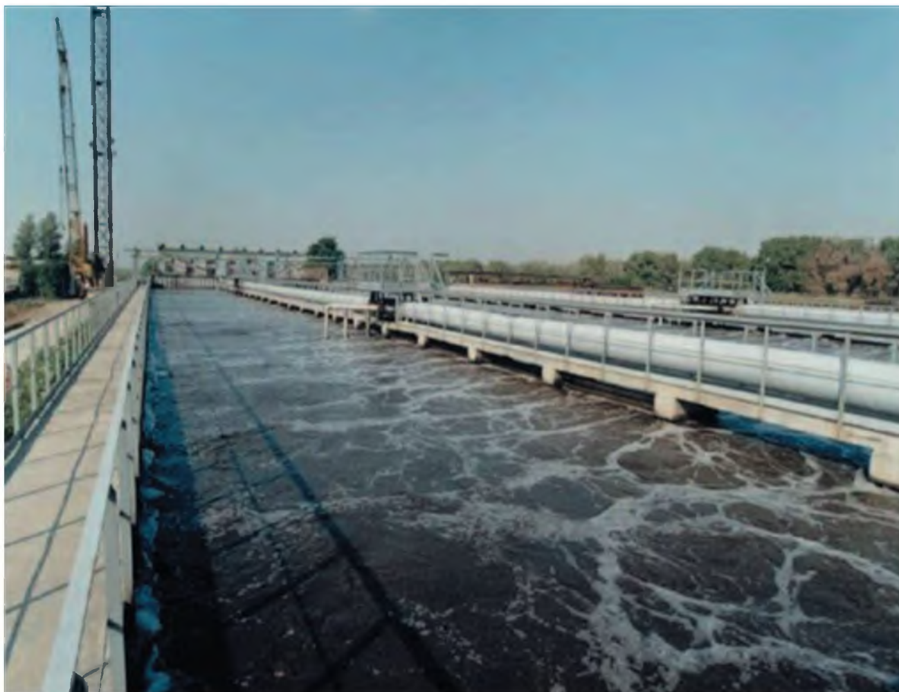
Фото 7. Аэротенки первой очереди очистных сооружений канализации города Ростова-на-Дону после реконструкции
